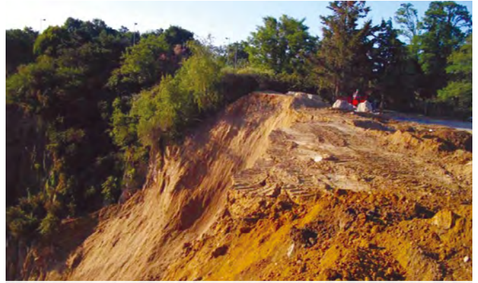
Plateforme de remblai instable
