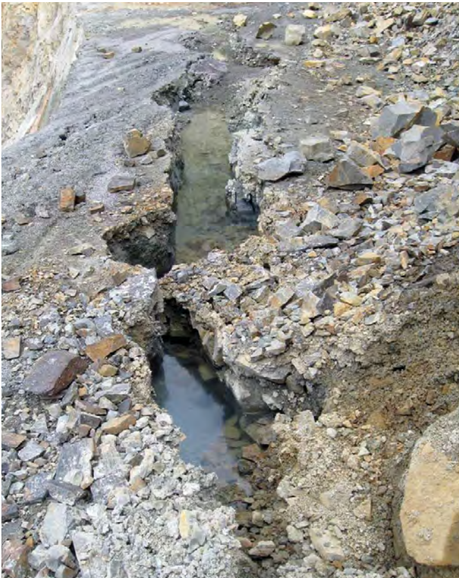
Apparition d'infiltrations d'eau
